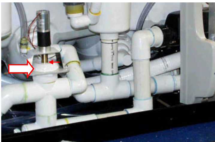
Pumpe 1 (neben Heizung hinter linken Seitenteil)
