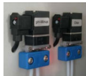
Wippenventil zur Dosierung der Chemikalien
